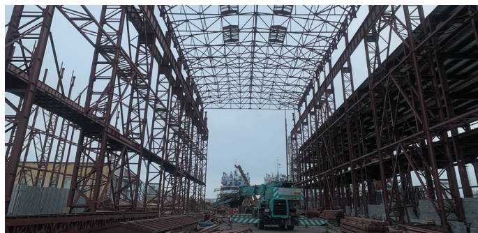
На Жатайской судовой верфи продолжается строительство первого этапа: возводится блок корпусных производств. Фото: sakha.gov.ru
